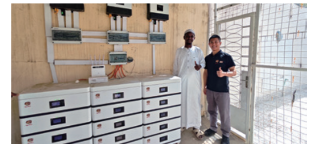
虎头公司为乍得人民提供电力保障
